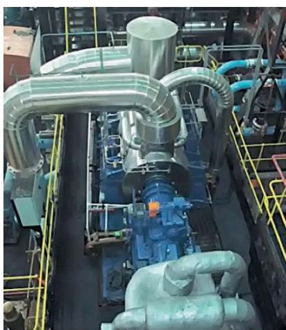
Установка после модернизации компанией Sulzer.
