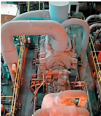
Старая установка до ее модернизации компанией Sulzer.
