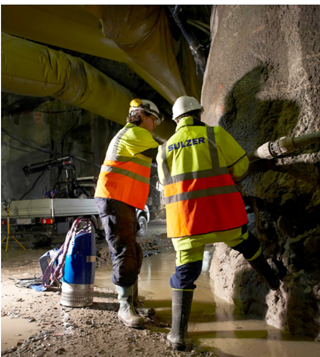
Instalación con bomba de achique XJ de Sulzer
