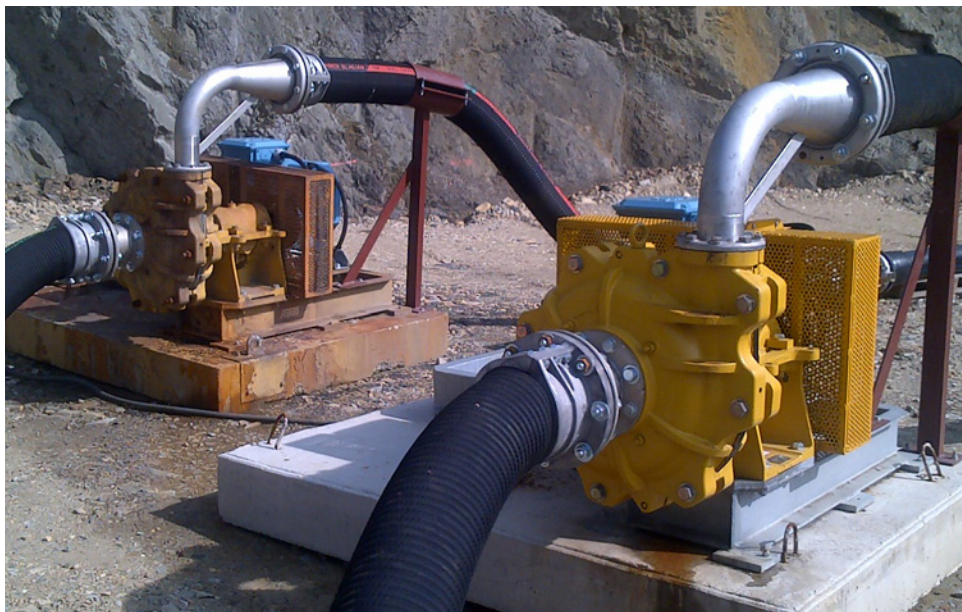
EMW slurry pumps
