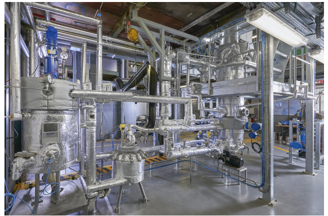
Die F&E-Anlage für die Produktion von Biopolymeren in Winterthur.
